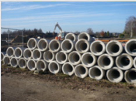
Riolering in opslag
